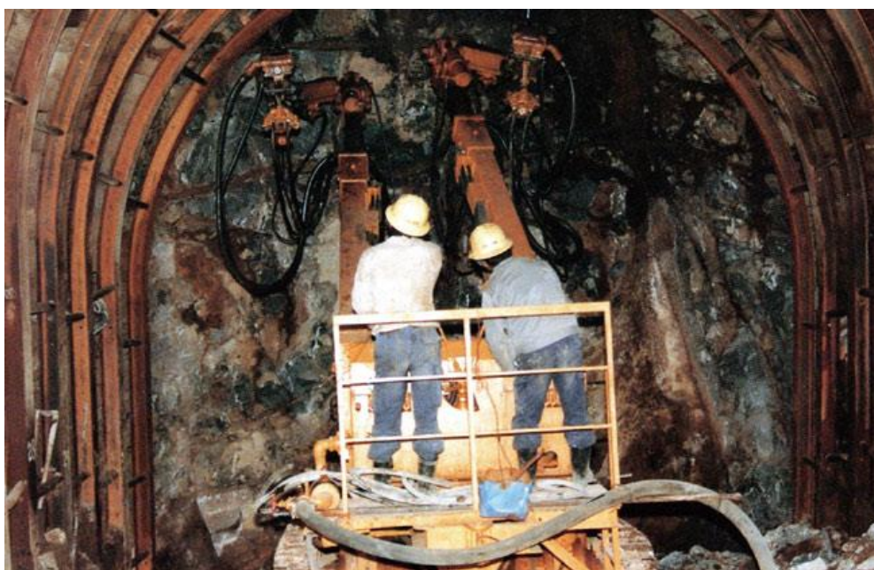
日本佐賀県唐津市にある韓日海底トンネル斜坑内部工事現場。第 3 期工事(斜距離 410~610m)が 2006 年 10 月から進められており、現在 547m まで掘削を終えた状態である。写真=推進団提供
